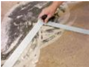
Рис.2.1. Укладка двустороннего скотча производится только на хорошо подготовленный, ровный и чистый пол
