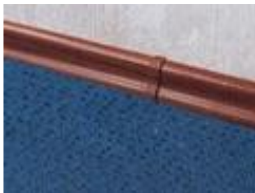
Рис.2.9. Установка плинтуса - завершающий этап работы. Отдельные элементы соединяют с помощью специальной фурнитуры
