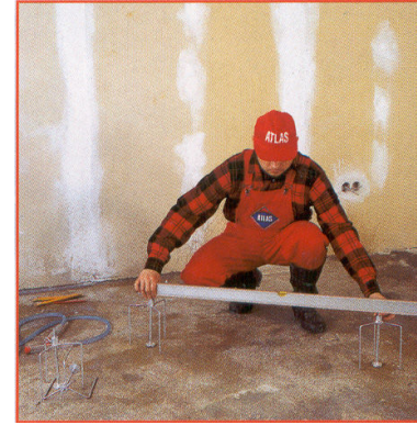
Рис. 1.4. Перед выливкой массы устанавливается первоначальный уровень толщины слоя (от 2 до 10 мм) в зависимости от степени неровности основания. Для этого определяют самую низкую и самую высокую точки. Выливка должна закрыть, как минимум, на 2 мм самую высокую точку. Нивелирование производится при помощи лазерного или обычного уровня. На этом этапе можно использовать переносные реперы. Они облегчают и ускоряют работу.
