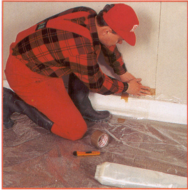
Рис. 1.11. Гидроизолирующий слой равномерно раскладывают по всей поверхности, так, чтобы он образовал водонепроницаемое «корытце». Оно ограничивает возможность вытяжки воды и цементного молочка из выливки в поры основания и последующее снижение прочности, либо препятствует попаданию влаги в перекрытие из мокрых помещений.
