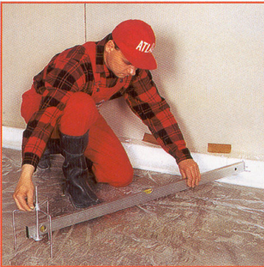
Рис. 1.12. Предварительно выставленный уровень (на стене) переносится с помощью реперов на всю поверхность пола.
