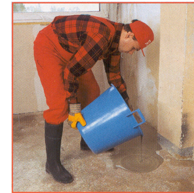
Рис. 1.6. Приготовленную смесь выливают на предварительно подготовленное основание, начиная от дальней стены и постепенно передвигаются в направлении к выходу. TERPLAN N необходимо выливать равномерно, полосами параллельными дальней стене. Соединение очередных партий выливки необходимо выполнять не позже 10 минут.
