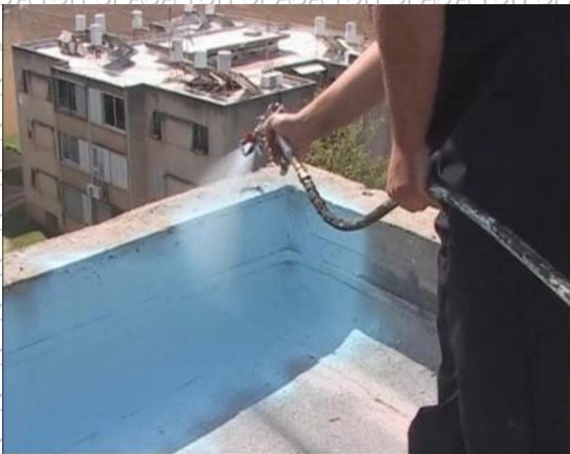
Мал. А.6. Нанесення мастики на місця примикань мастичного покрівельного килима до парапетів
