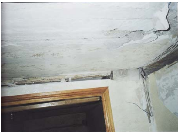
а) щілини всередині будівлі
