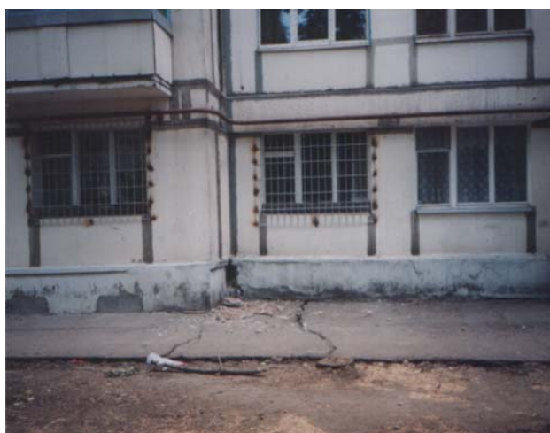
Рис. 6. Фрагмент будівлі з відсутністю зливової каналізації.
