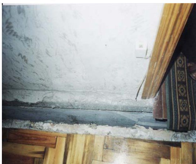
в) відрив стінового блоку від плити перекриття
