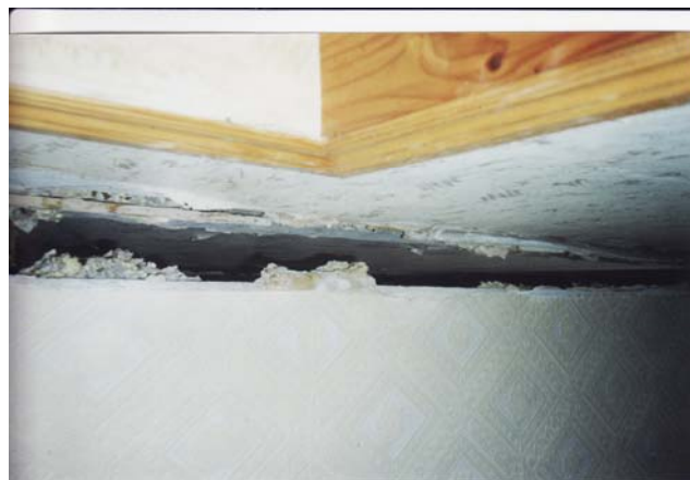
б) розрив плити перекриття від стіни
