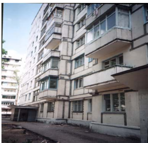
Рис. 5. Наслідки розмивання вимощення.
