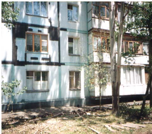
Рис. 3. Фрагмент будівлі з відсутністю злизової каналізації
