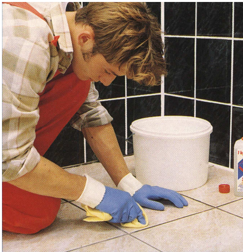
Рис. 2.26 – Очищення забруднених місць.
