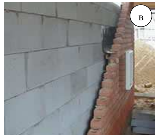
Рис. 3.1 – Варіанти кріплення цегляного облицювання до фасада а – зв'язками з дроту; б – відрізками арматури; в – клямерами
